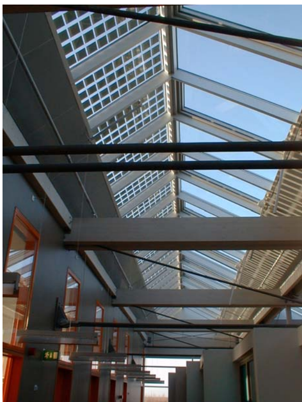
Figur 1.1 Oventagvinduer med PV i taget i Ikast-seminariet
